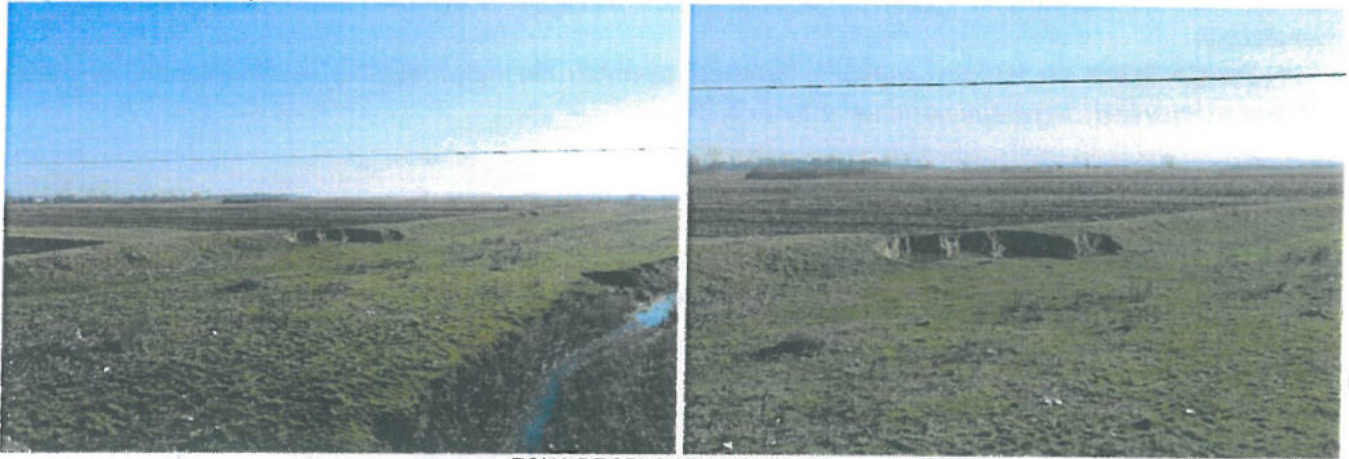
ZONA DEGRADATA A DIGULUI
